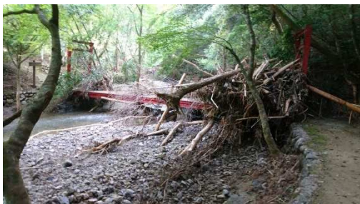
桂川溪谷被災状況
